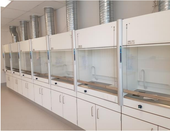
Avtrekksskap på Jessheim VGS, klar for elevenes eksperimenter.
